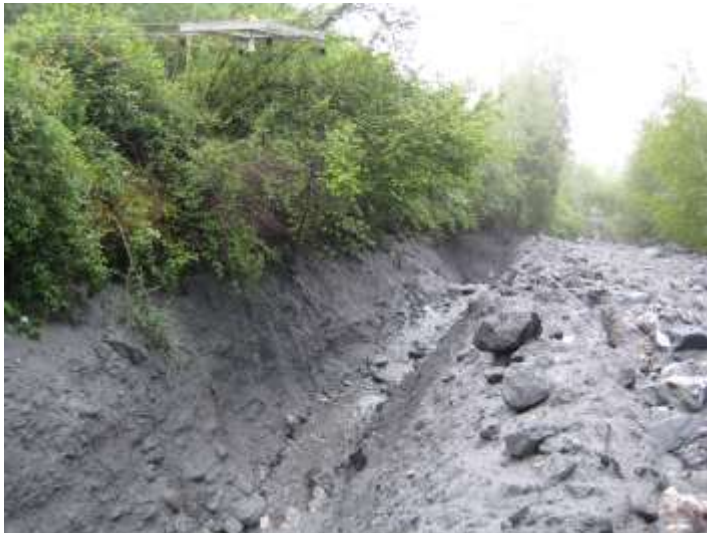
Abbildung 5. Radar zur Messung des Abflusspegels beim Kegelhal. Installiert und betrieben von Geopraevent AG im Auftrag des AWN GR.
